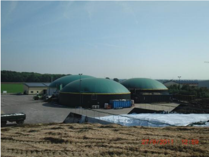
Abbildung 6-4 Biogasanlage in Wallerstädten (GGV, 2012)
