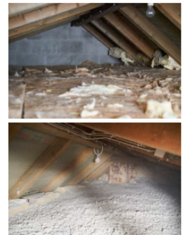
Abbildung 1: Dämmung der obersten Geschossdecke mit Klemmfilz aus Glaswolle (oben) und mit Zelluloseflocken (unten).
